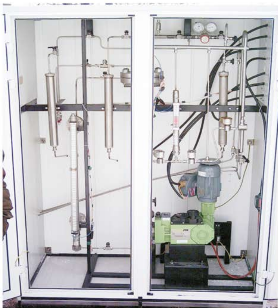
Fig. 2 - Mod de realizare fizică a instalației automate de odorizare prin eşantionare, la înaltă presiune
